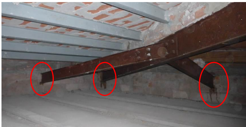
F18, 19 i 20 Imatges de l'entrada d'aigua a les cobertes de les cantonades de l'edifici.
