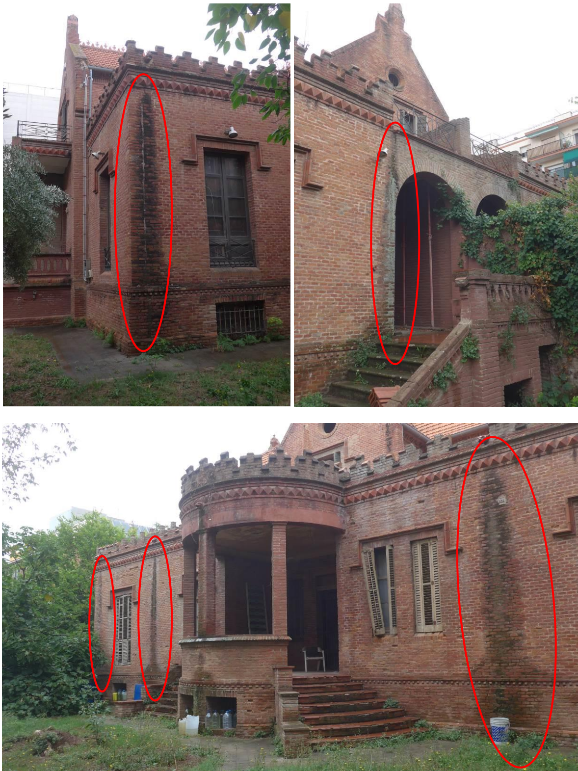
F-21 Imatge de l'entrada d'aigua per un dels aiguafons de la coberta.
