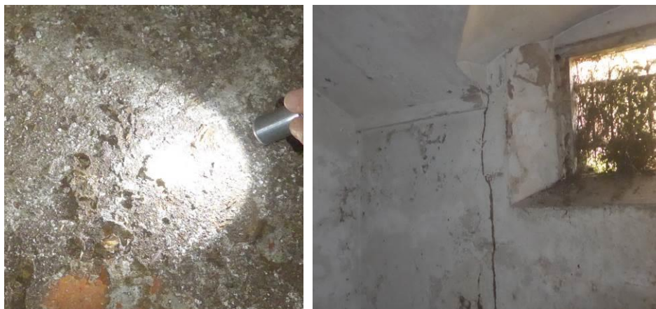
F-22 i 23 Imatge dels tèrmits de la planta soterrani.
